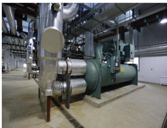
冷水机组实拍图
