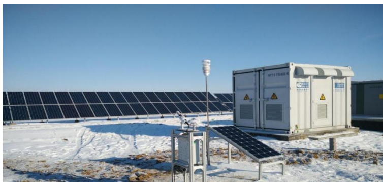
图 45 新疆某大型集中式光伏电站
