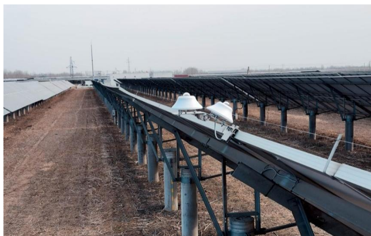
图 43 江苏某分布式光伏电站（地面式）
