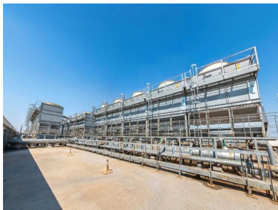
冷却塔实拍图
