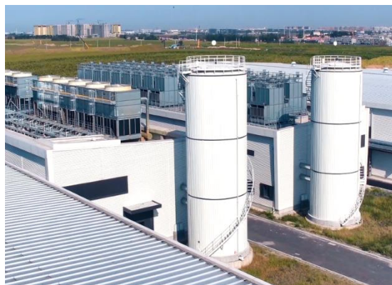
蓄冷罐实拍图
