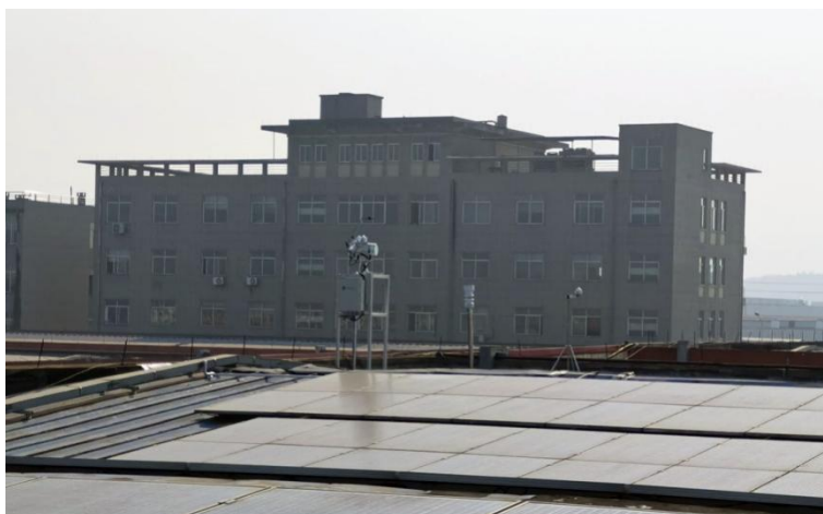
图 44 江苏某分布式光伏电站（屋顶式）
