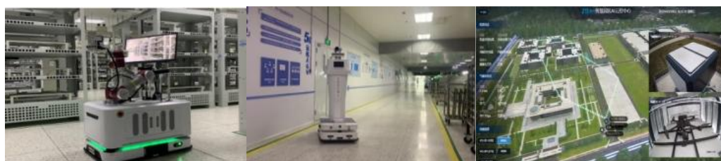
图 17 无人智能巡检
